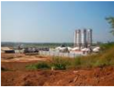
写真-6 コンクリートプラント
